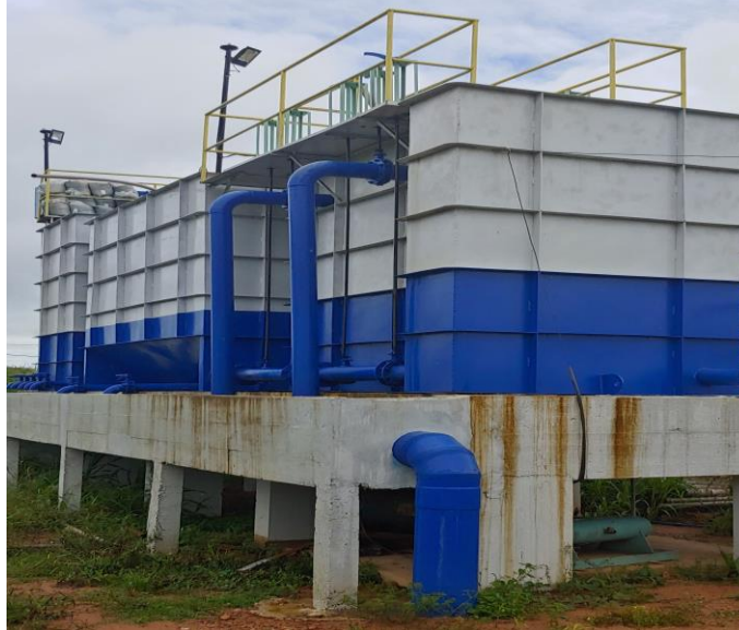
Imagem 3. Condições atuais da Estação de tratamento 5 l/s
