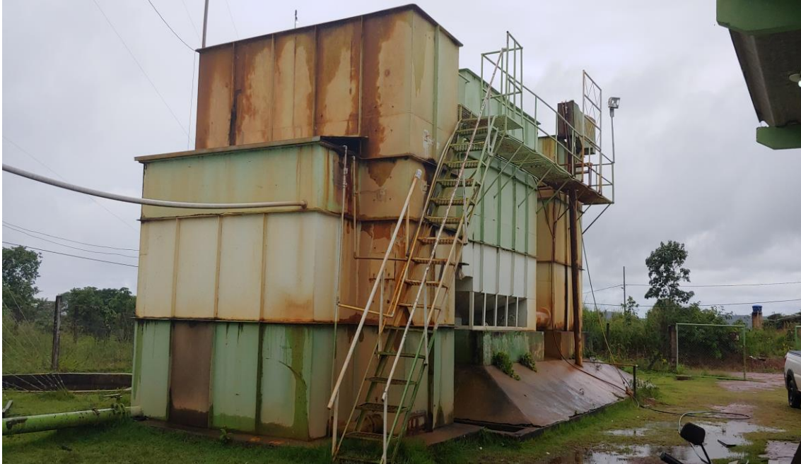
Imagem 2. Condições atuais da Estação de tratamento 10 l/s
